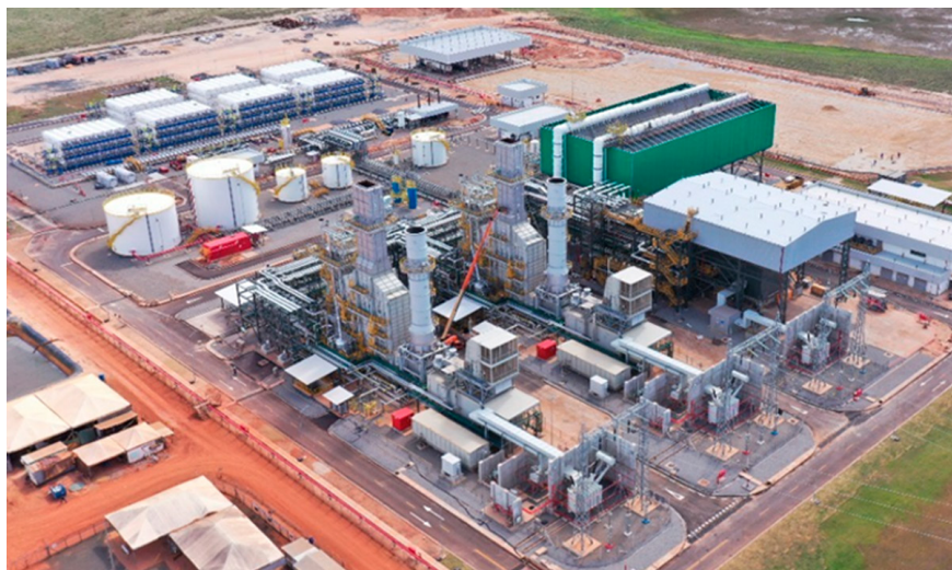
Figura 4 - Usina Termelétrica Jaguatirica II – Boa Vista – RR, geradora de 48,653 MW, substituindo o diesel pelo gás natural
